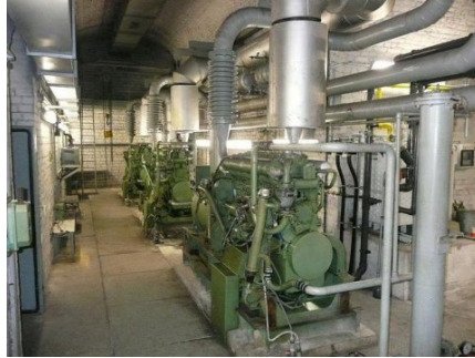
Şəkil 6.14. Dizel elektrik stansiyası
